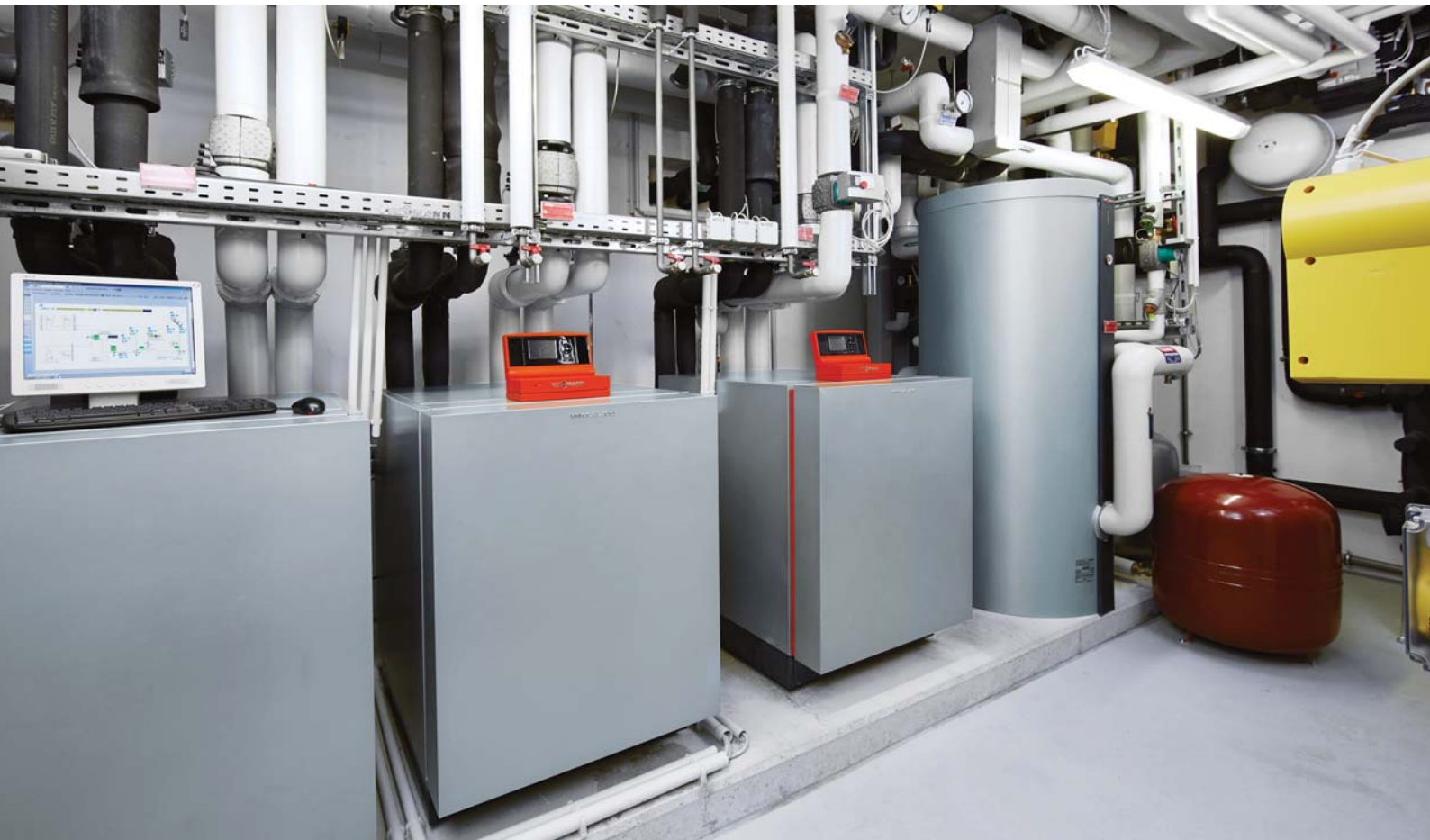
Master/Slave-Anordnung von zwei Wärmepumpen Vitocal 300-G für die Heizung. Eine Vitocal 350-G (rechts) liefert Warmwasser.
