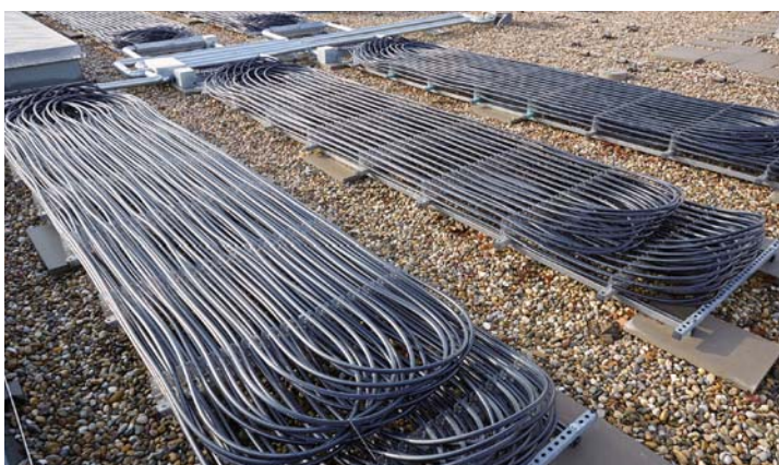
Solar-/Luftabsorber auf dem Dach entziehen Sonne und Luft Wärme und lagern sie im Eisspeicher ein.
